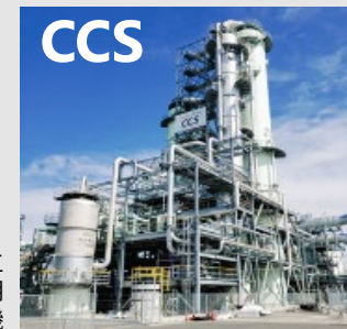
2020年10月竣工 シグマパワー有明 三川発電所実証機
