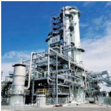
大規模CO 2 分離回収実証設備
